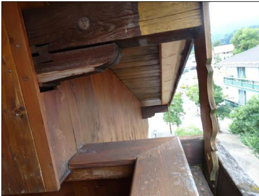
Abb. 10: Potenzielle Spaltenquartiere an der Giebelseite West.
