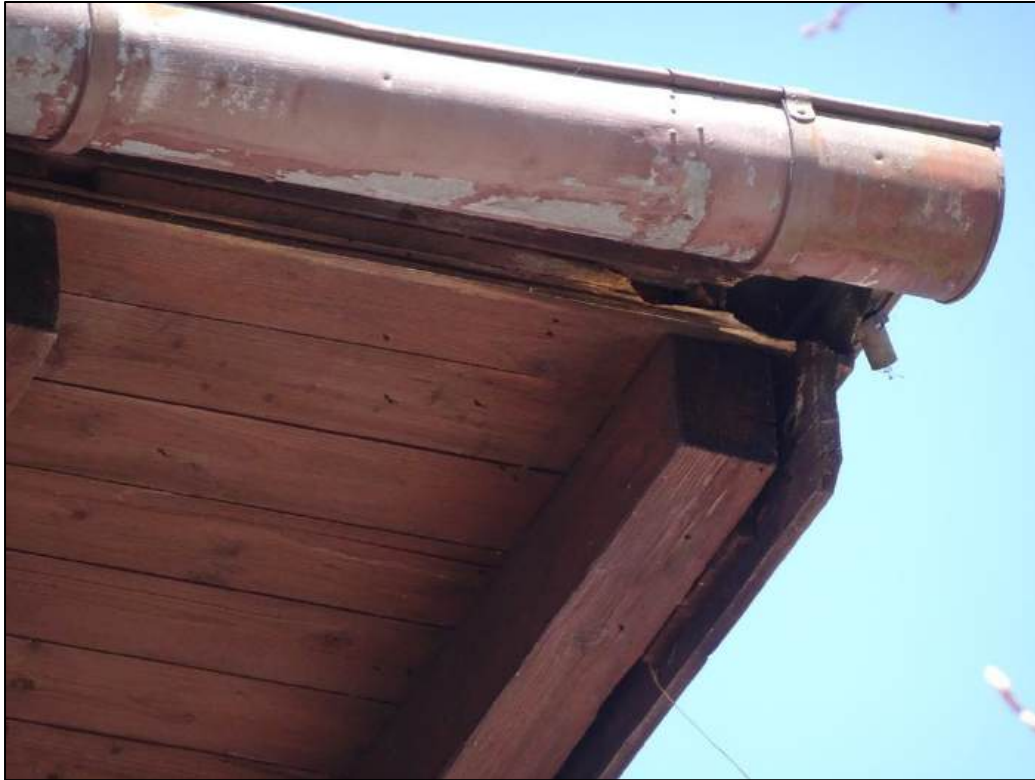
Abb. 11: Dachkante mit Zugang, auch Zugang für Marder möglich.
