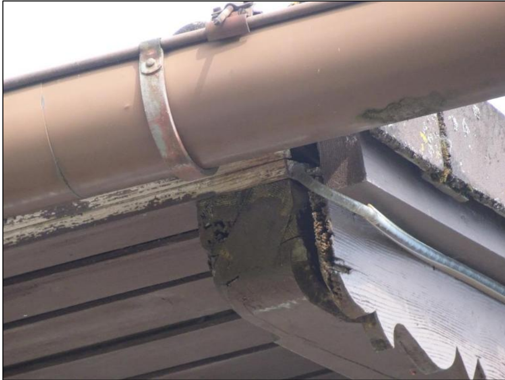
Abb. 12: Dachkante mit Zugang, für Marder geeignet.
